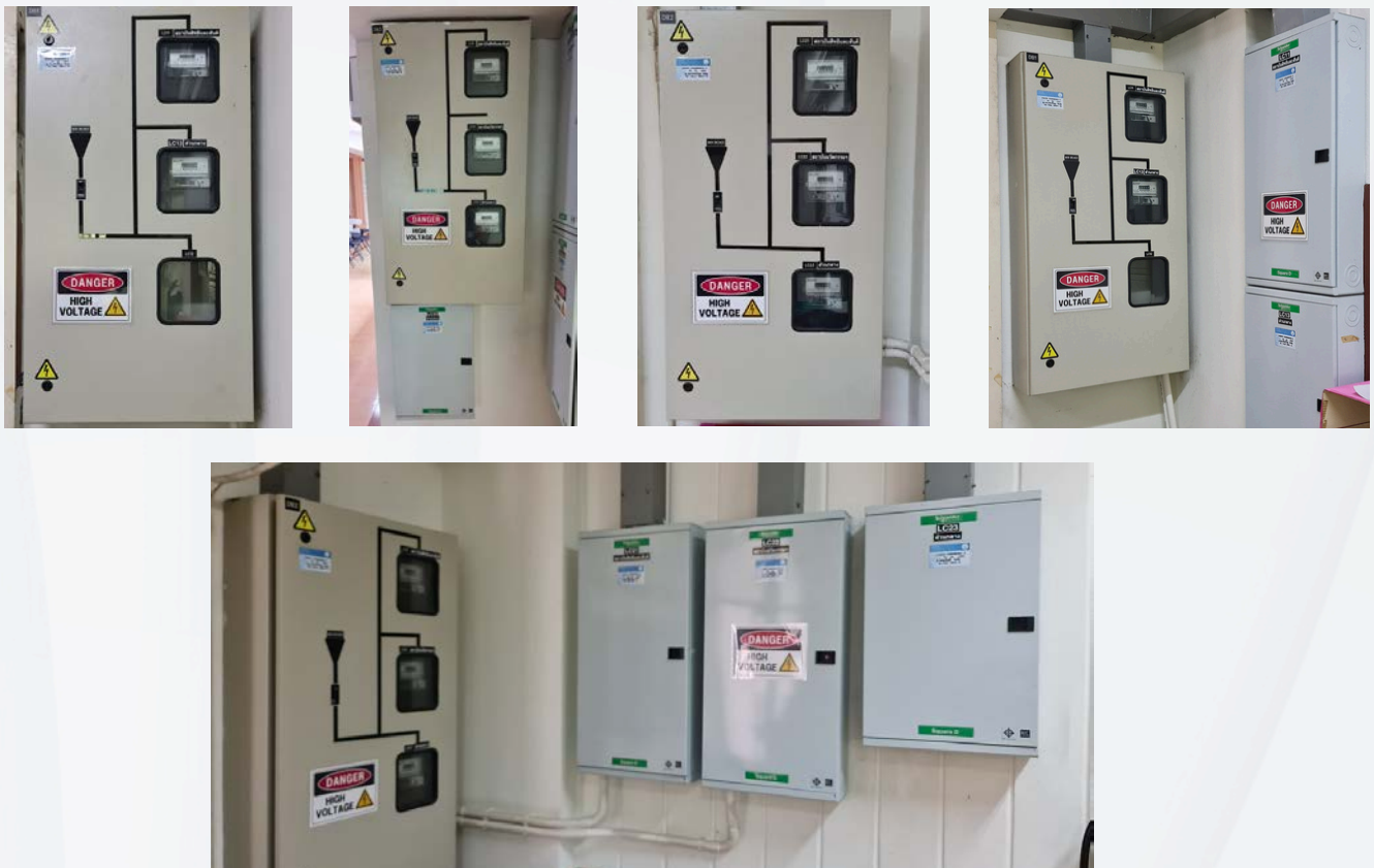
รูปที่ ๒.๑๓ แสดงตู้เบรกเกอร์หลักในอาคารปัญญาพิพัฒน์
